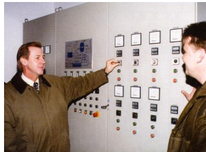
Blick in die Schaltwarte
