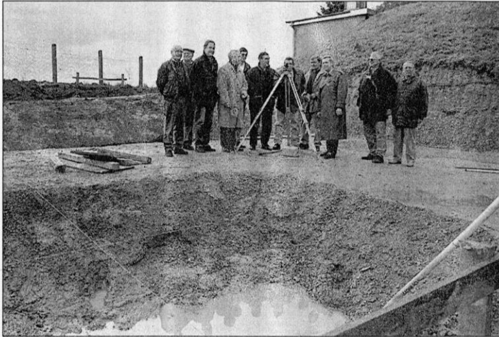
Die Richtung stimmt, und die Baugrube ist auch schon ausgehoben: Hier, am Hochbehälter von Kleinenglis, entsteht die Aufbereitungsanlage, die dem Trinkwasser die Säure entziehen soll. (Foto: Rohde)
