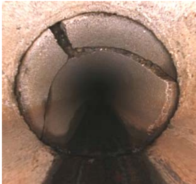
Kanalschaden in Vorwärtsansicht und
