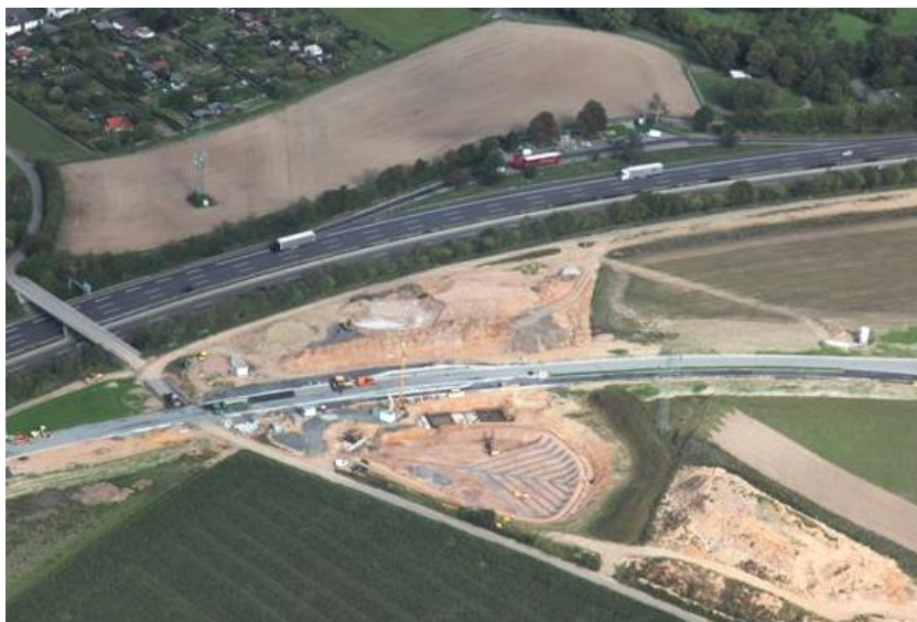
Luftbild mit RRB in Bau, oben die Autobahn A7 und der Ortsrand von Sandershausen
