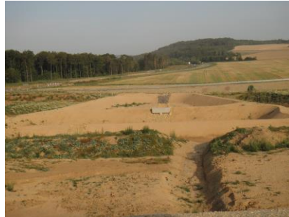
Absetzbecken und RRB Maibach
